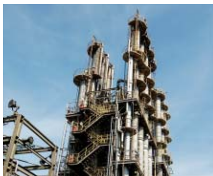
多結晶シリコン設備
