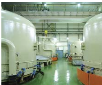
多結晶シリコン設備
